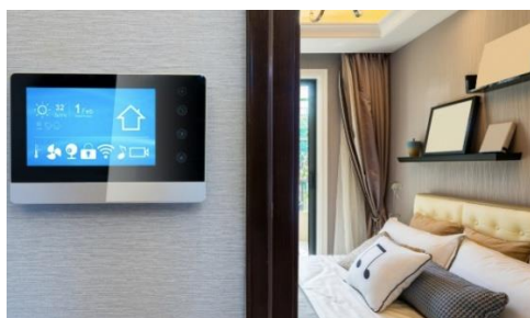
Figura 4. Pannello di controllo nella stanza
