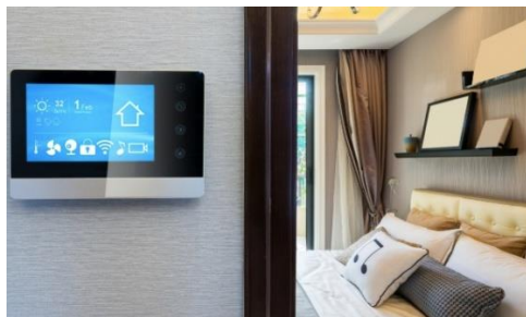
Εικόνα 4. Πίνακας ελέγχου στο δωμάτιο
